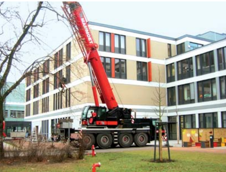
■ Abb. 1: Kinderradiologie im Erdgeschoß des neuen Frauen- und Kinderzentrums der Universität Leipzig. Ein Spezialkran ist für den Einbau der Geräte notwendig.
